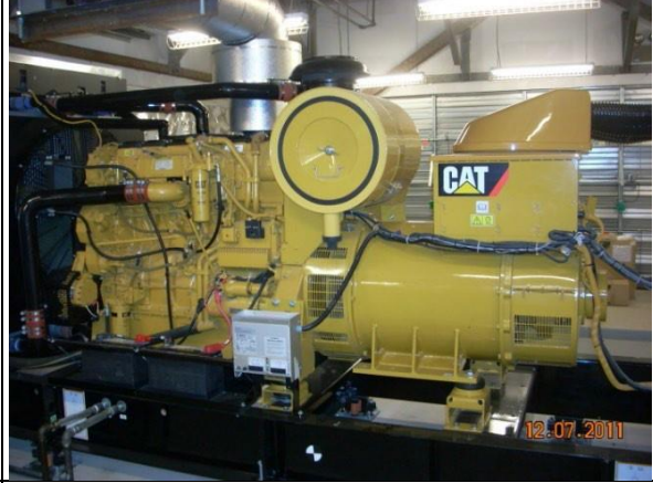
أنظمة الخزانات الأرضية بمولدات طوارئ يتم تزويدها بالوقود باستخدام مادة خاضعة للوائح مثل الديزل وهي خاضعة للوائح القسم.
