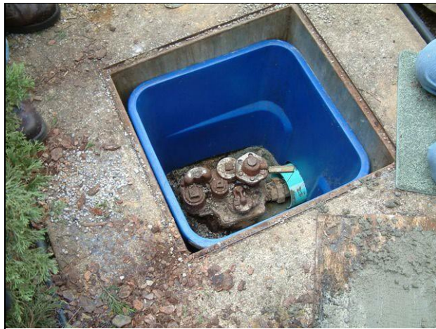
حوض غير مزود بالاحتواء يستخدم حاوية بلاستيكية لمنع الردم من الانهيار فوق رأس المضخة. لا يحقق هذا معايير التركيب الحالية.
