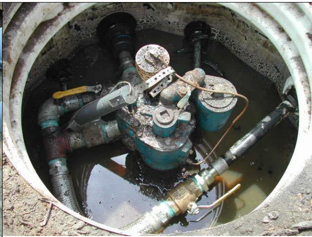
المياه والمنتج في الحوض تم إخراج المستشعر من مكانه ولا يمكنه كشف السوائل في الحوض بالشكل المناسب
