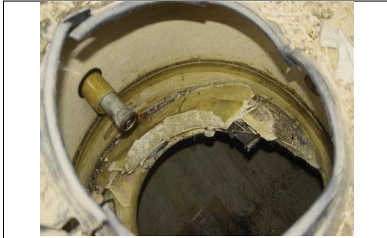
فتحة الممر تالفة نتيجة عملية توصيل تحت ضغط إلى خزان مجهز بصمام عوامة كروية.
