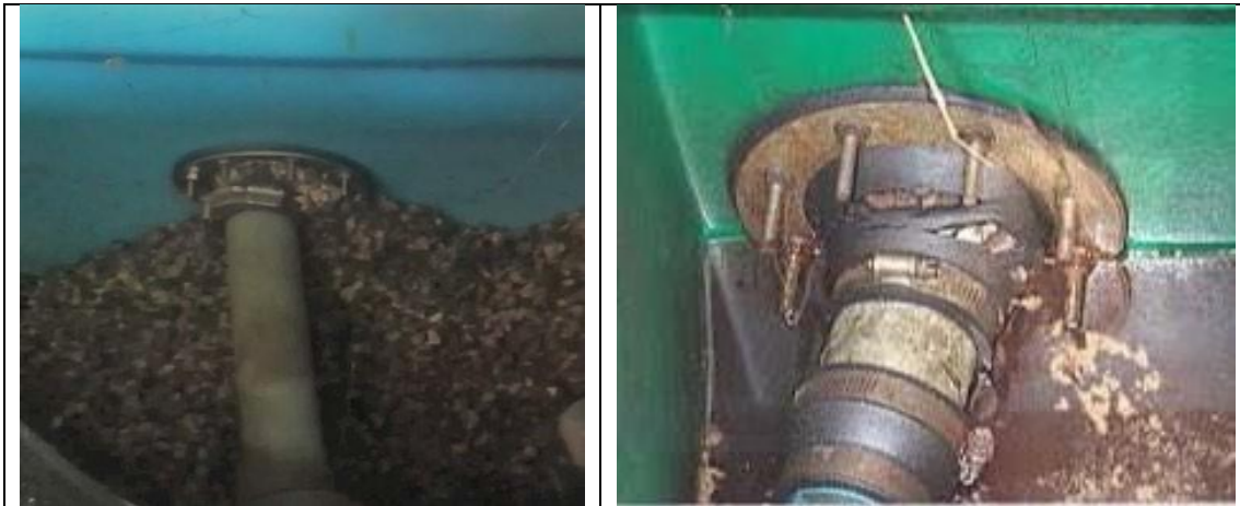
توضح الصور أعلاه تركيبات اختراق تالفة تسمح للحصى بالانهيار لدخول الحوض. لم يعد الحوض محكمًا ضد تسرب السوائل.
