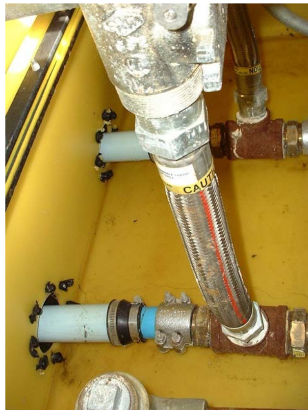
加油机密封装置 集液槽下方
