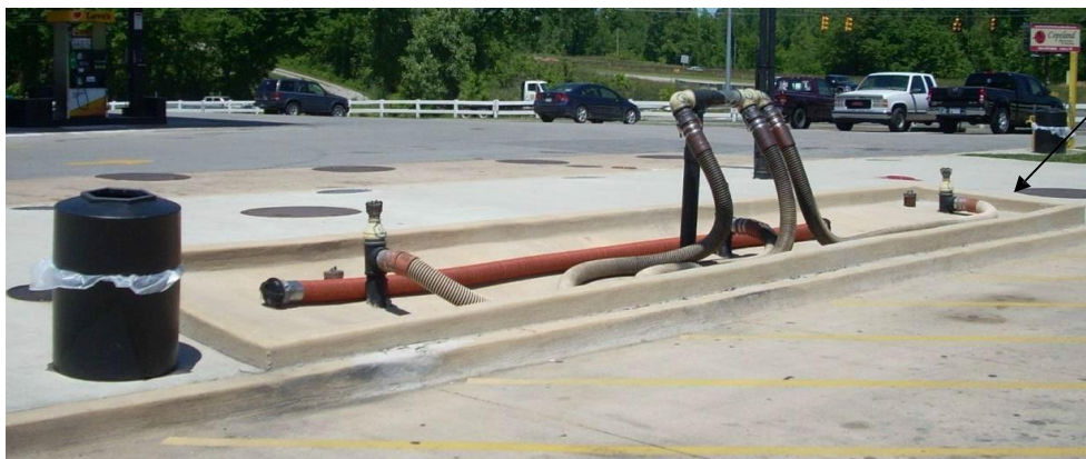
Khu vực chứa tràn đổ trên vỉa hè
