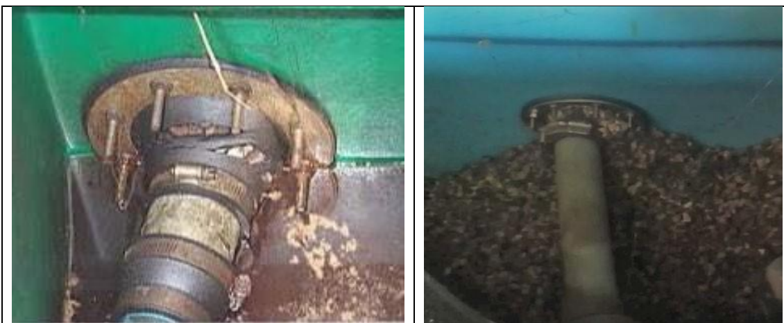
Các ảnh trên cho thấy các phụ kiện bịt kín bị hư hại khiến cát sỏi có thể lọt vào bể gom. Bể gom không còn kín chất lỏng nữa.
