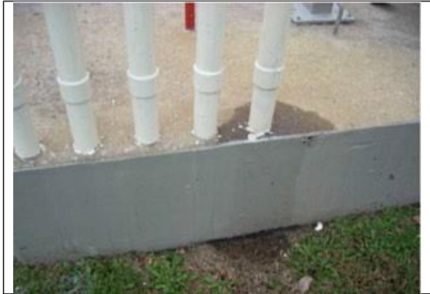
Bồn chứa đầy tràn có thể gây ra rò rỉ từ ống thông khí
