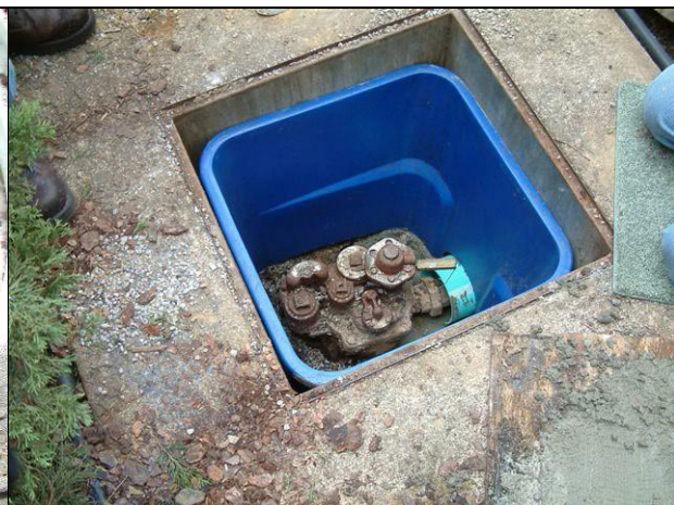
Bể gom hở sử dụng ngăn chứa bằng nhựa để ngăn không cho đất đá rơi vào đầu bơm. Việc này sẽ không đáp ứng các tiêu chuẩn lắp đặt hiện tại.
